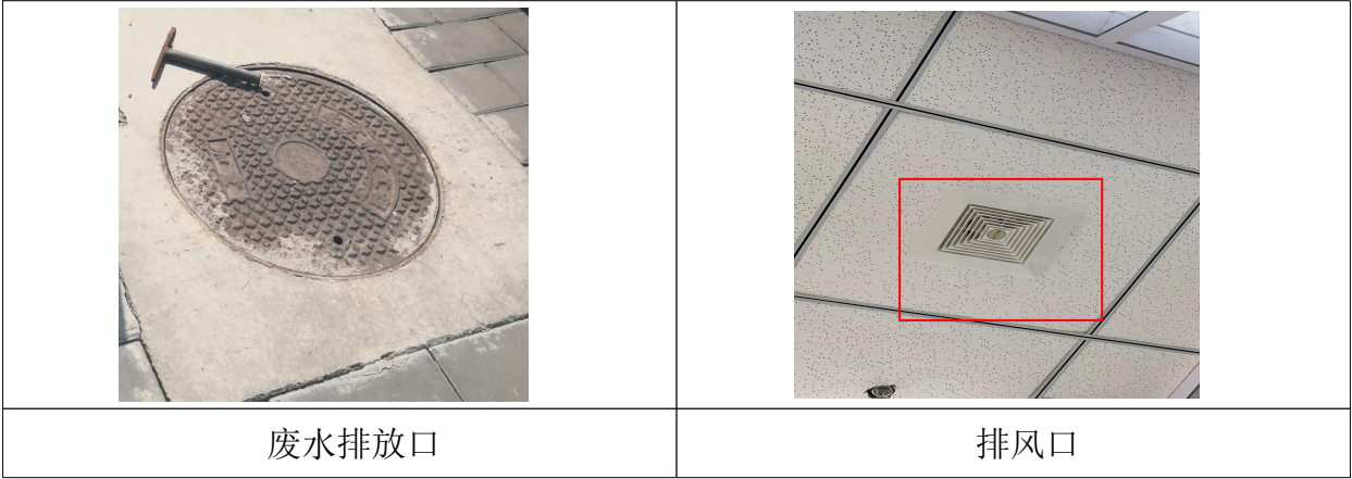
图 4-1 废水排放口照片
