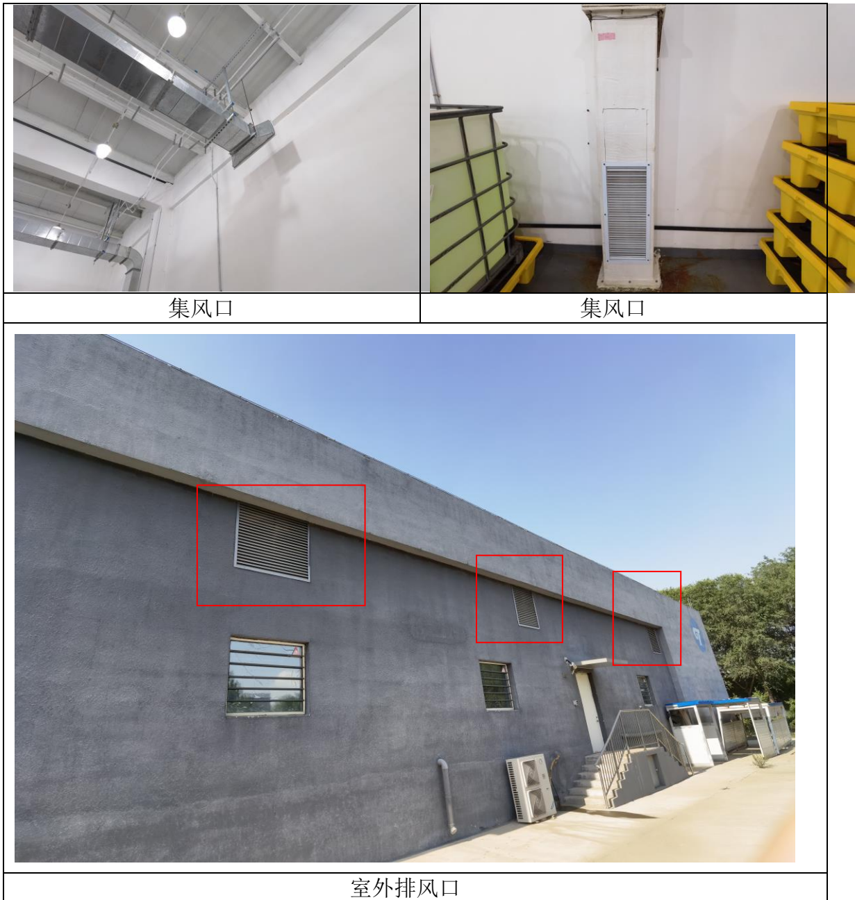
图 4-1 废气治理设施照片
