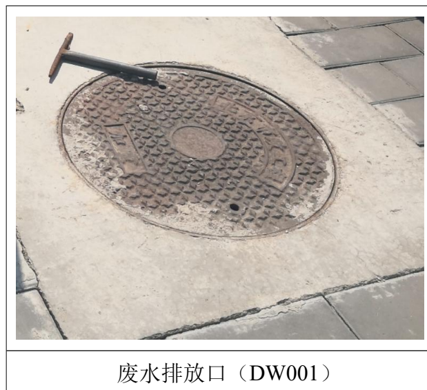
图 4-2 废水排放口照片
