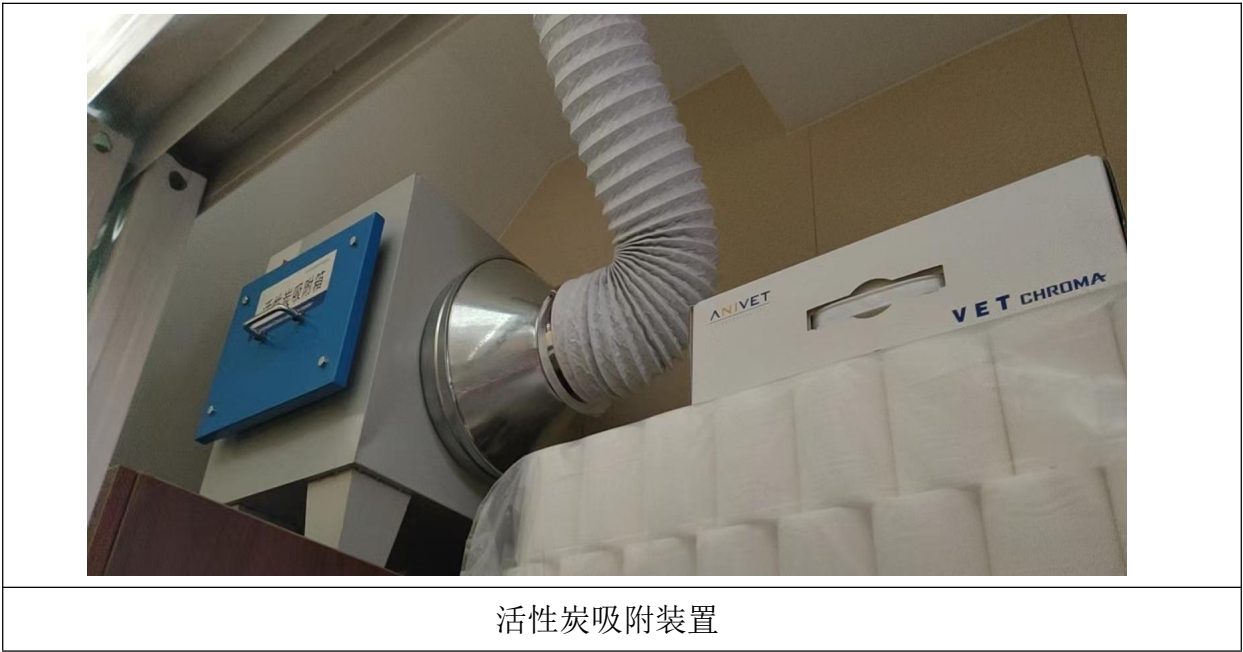
图 4-1 废气治理设施照片
